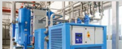
压缩空气和气动装置
